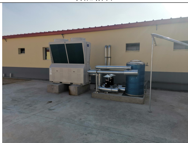
空气能供热系统
